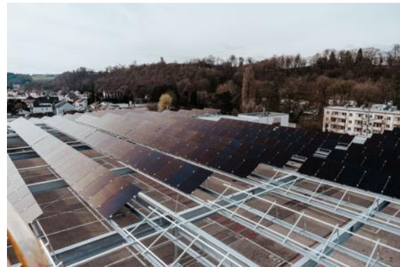
Bild: 06 CCA PV Anlage 2024.jpg
